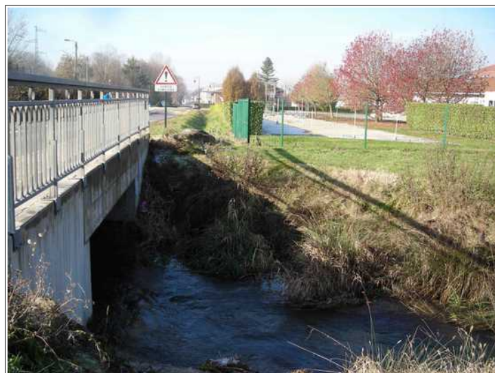
Pont de la RD143, on notera le virage à 90^\circ du ruisseau et le risque de le voir déborder à l'amont de l'ouvrage.
