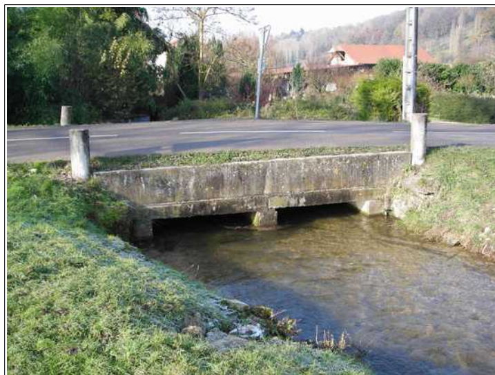
Vue du pont de la RD54f, on notera sa faible ouverture. En débordant, le ruisseau peut se diriger en direction des constructions visibles en arrière plan sur sa rive droite.
