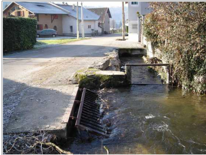
Le ruisseau de SAINT-SAVIN longe la voie communale rejoignant la RD143 et la VERCHÈRE. Des aménagements hydrauliques le contraignent et augmentent le risque de débordement. Plusieurs maisons sont menacées d'inondation.
